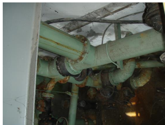
Potrubní rozvody ČOV
